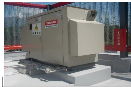
非常発電設備
