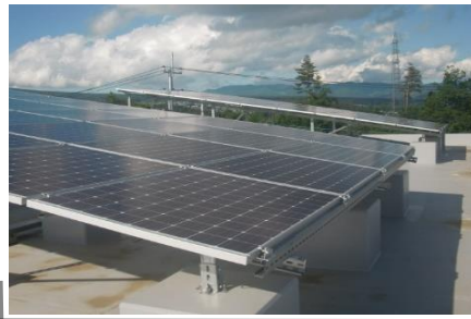
太陽光発電設備
